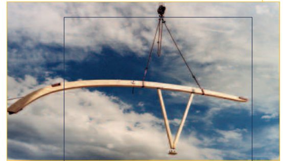
Teil der Konstruktion der temporären Überdachung für die Filmnächte am Elbufer Dresden
